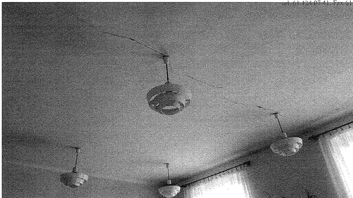
Spękany sufit – budynek główny I piętro.
